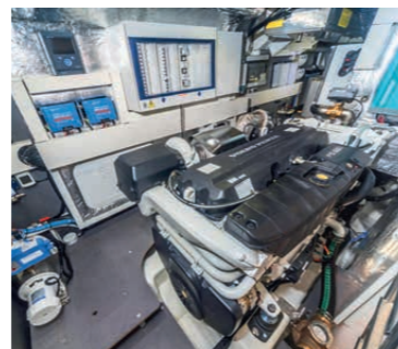
Viel Platz gibt es auch im Maschinenraum. Alle Aggregate sind für Servicearbeiten gut zugänglich
